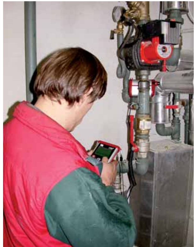
▲ Auf die dokumentierte hydraulische Einregulierung auch bei Solaranlagen nicht vergessen!
