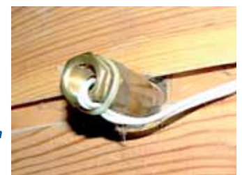
▶ Temperatursensoren sind gegen Herausrutschen aus der Tauchhülse zu sichern.
