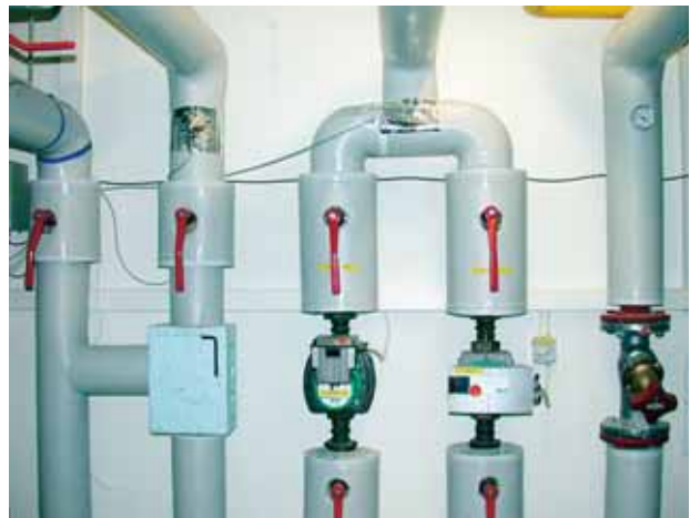
▲ Armaturendämmung sollte Standard in modernen Wärmeversorgungssystemen sein.
