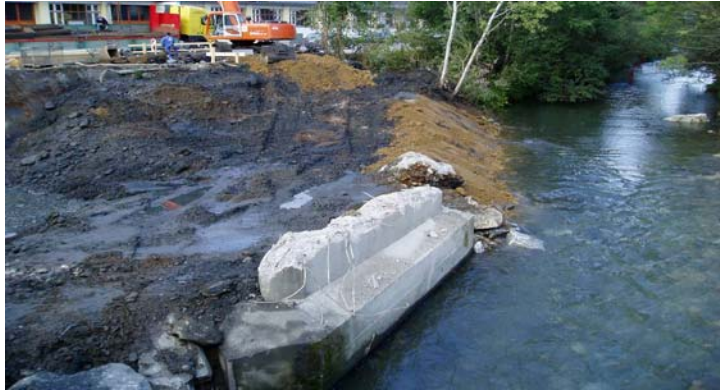
Abb. 3: Altlasten im Baustellenbereich
