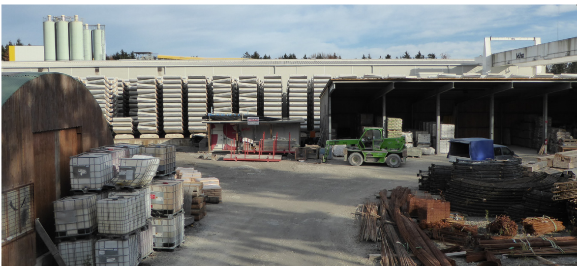
Abbildung 4: Fotostandpunkt Nr. 2. Blick Richtung Osten . ÖBB-Baustelleneinrichtung „Zwischenangriff Leibenfeld“ (Quelle: PLANUM, D. Fleck, 20.11.2015)
