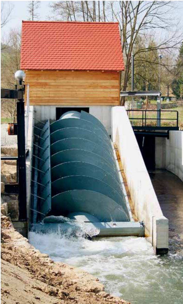
Abb. 5: Mit einer Wasserkraftschnecke, wie etwa dieser von ANDRITZ, soll in der Kläranlage in Gössendorf Energie gewonnen werden. (Credit: Andritz)
