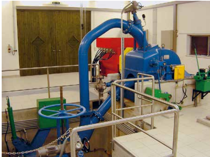
Abb. 3: Ohne Beeinträchtigung der hohen Wasserqualität wird in St. Katharein an der Laming Strom erzeugt. (Credit: ZWHS)
