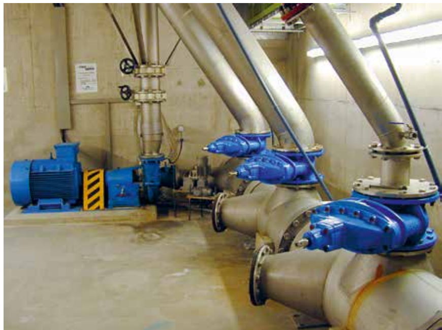
Abb. 4: Das Werk Hansenhof in Bruck an der Mur ist das zweite von drei Trinkwasserkraftwerken zwischen dem Hochschwabmassiv und Graz. (Credit: ZWHS)
