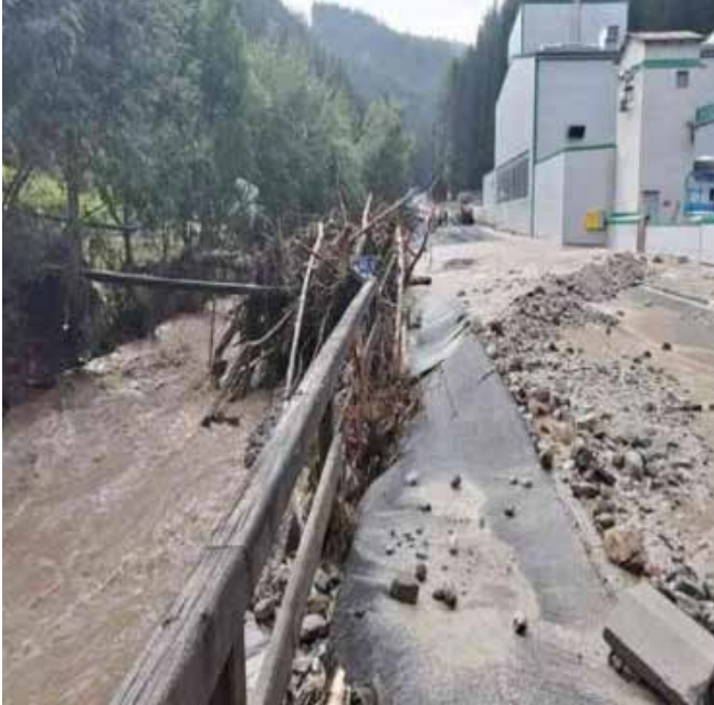
Abb. 4: Teilweise zerstörte B 72 Weizer Straße entlang des Hirschbaches © WLV
