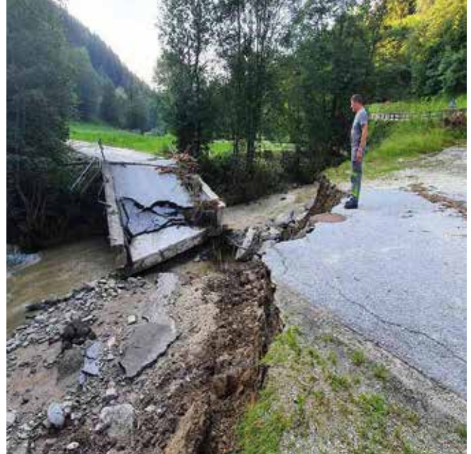
Abb. 5: Zerstörte Landaubücke, Hirschbach bei hm 11,50 © WLV
