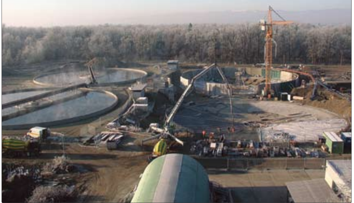
Abb. 9: Blick auf die neuen Nachklärbecken, zwei Becken in Betrieb, zwei Becken in Bau
