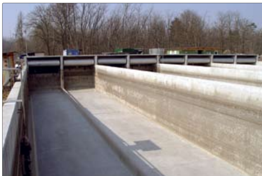
Abb. 4: Mischwasserüberlaufbecken mit Spülkippen im Hintergrund
