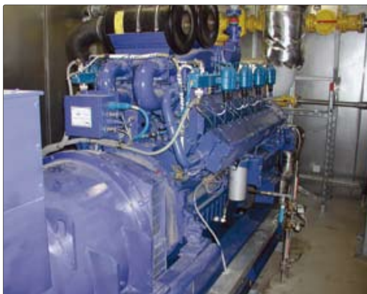
Abb. 8: Innenansicht eines Blockheizkraftwerkes
