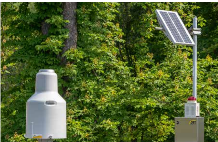
Abb. 4: Messstelle Rückhaltebecken Zusertalgerinne Graz © Foto Fischer
