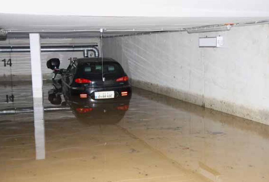
Abb. 4: Das Hochwasser am Schöckelbach im Sommer 2009 flutete auch mehrere Tiefgaragen
