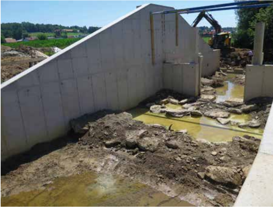
Abb. 6: Drosselbauwerk Lusenbach mit ökologischer Ausgestaltung © Daninger & Partner ZT KG
