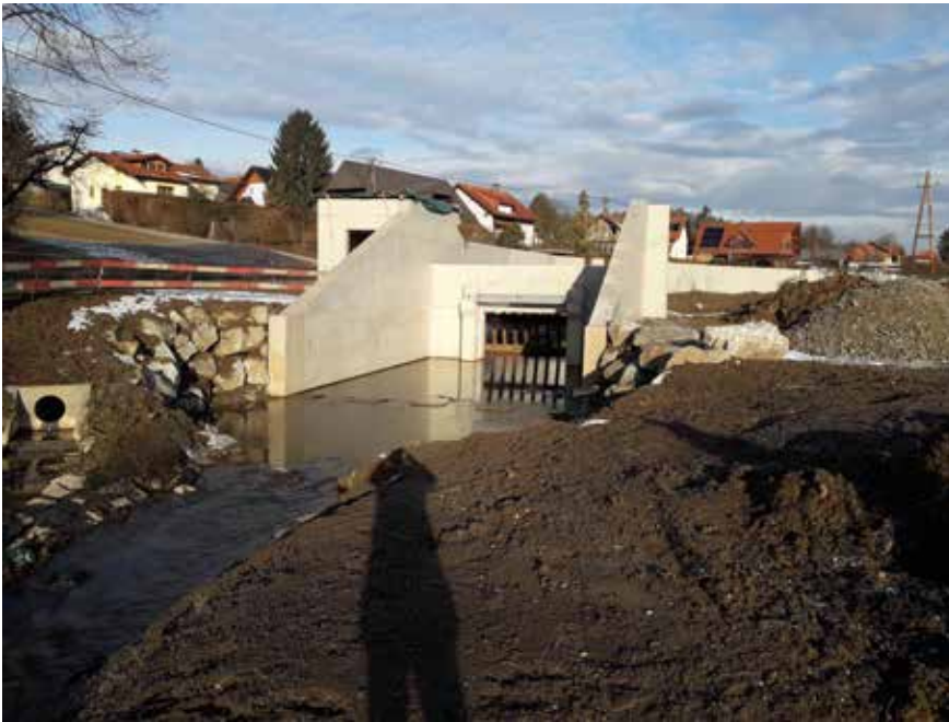
Abb.7: Drosselbauwerk Liebochbach mit Betriebsgebäude © Daninger & Partner ZT KG
