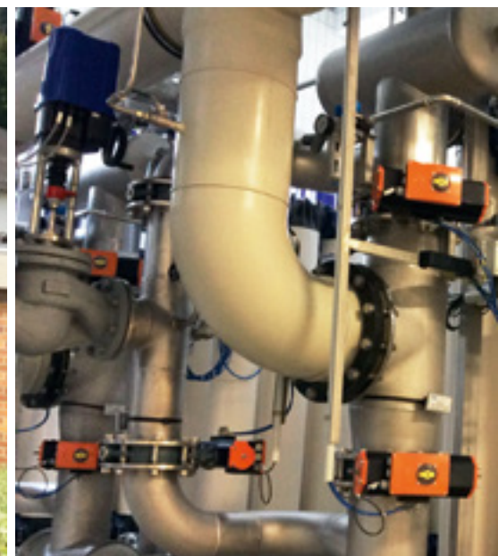
Abb. 2: Ultrafiltrationsanlage © W. Ederer – Stadtgemeinde Weiz
