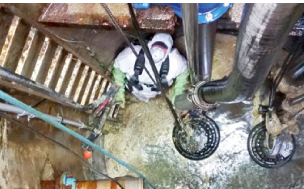
Abb. 3: Notwendige Reinigung des Pumpwerks wegen Verstopfung. © GSA
