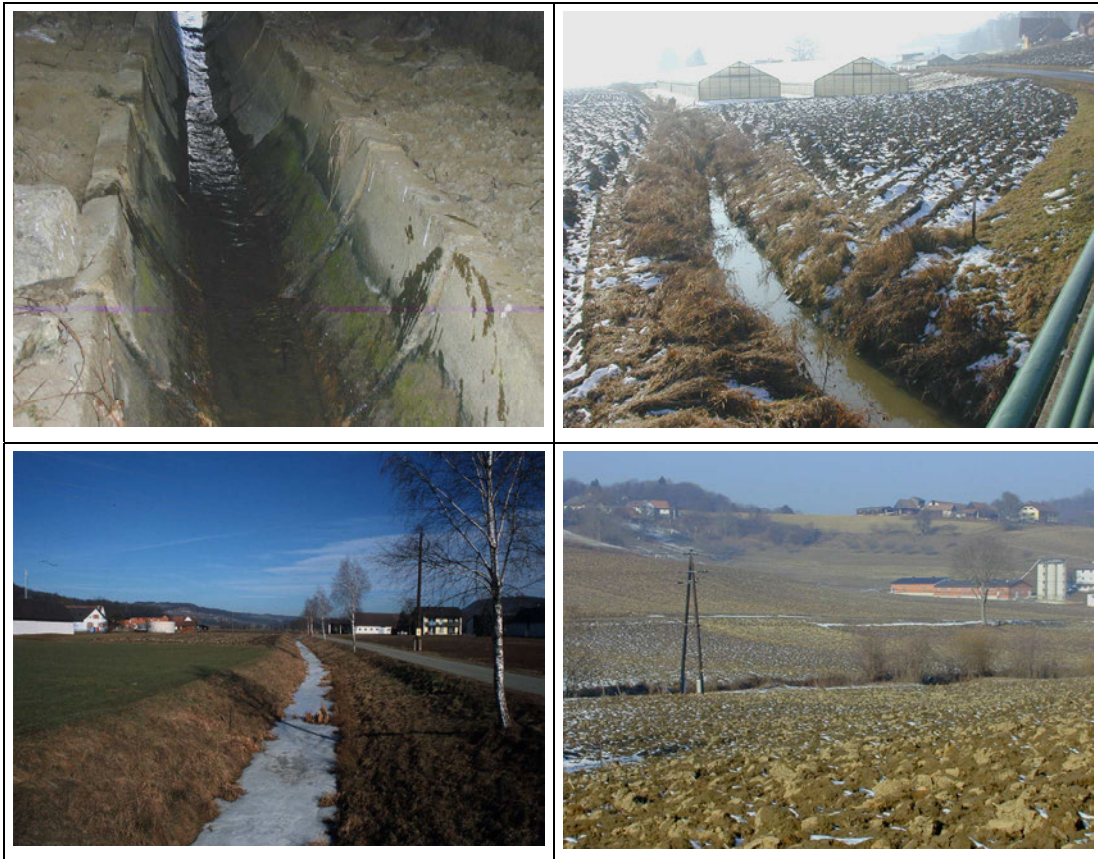
Abb. 50, Abb. 51, Abb. 52, Abb. 53: oben links: Kontrollpunkt 1 – Oberlauf des Poppendorferbaches im Brückenbereich in Ludersdorf mit Halbschalen verbaut; oben rechts: Kontrollpunkt 2a – Poppendorferbach im Oberlauf SE von Maierdorf begradigt und verbaut, ohne Gehölzstreifen, Äcker reichen bis knapp zum Gewässer; unten links: Hartelbach bei Hürth (Kontrollpunkt 51) – begradigt, kein Gehölzstreifen, die Uferböschung wird durch regelmäßige Mahd offengehalten; unten rechts: Umgebung des Kontrollpunktes 4a am Poppendorferbach – ausgeräumte Landschaft, intensiv landwirtschaftlich genutzt.
