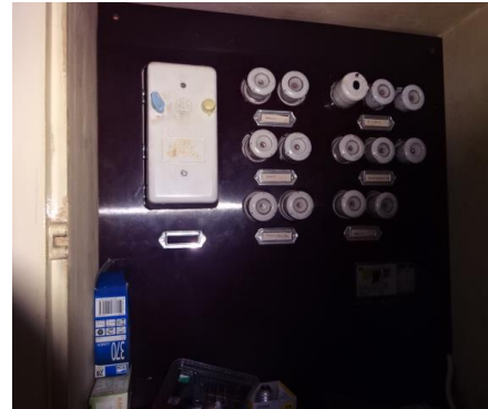
Abbildung 31: Foto Schalt- bzw. Verteilerschrank; aufgenommen am 15.06.2022
