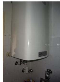
Abbildung 33: Foto Warmwasserboiler; aufgenommen am 15.06.2022
