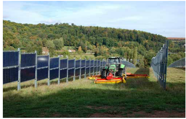
Bild 27: Vertikal errichtete bifaziale Module im Solarpark in Eppelborn-Dirmingen, Saarland mit 2 MW p Leistung, errichtet von Next2Sun. © Next2Sun GmbH
