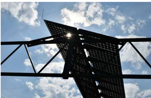
Bild 14: Modulreihe mit bifazialen Modulen der Agri-PV-Anlage in Heggelbach. © Fraunhofer ISE
