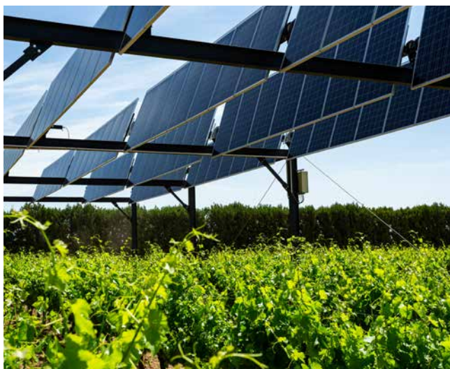
Bild 41: Einachsiges Trackersystem einer Demonstrationsanlage in Frankreich. © Sun'Agri
