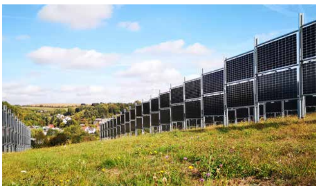
Bild 35: Bifaziale, senkrecht aufgestellte Module von Next2Sun, Donaueschingen. © Next2Sun GmbH
