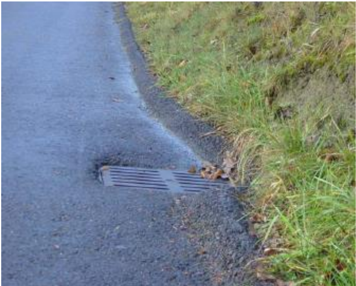
Abbildung 20: Schacht mit Einlaufgitter
