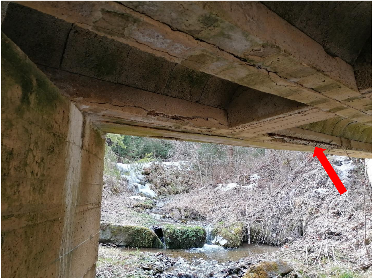
Abbildung 27: Unterkonstruktion einer Brücke mit freiliegender Bewehrung (roter Pfeil)
