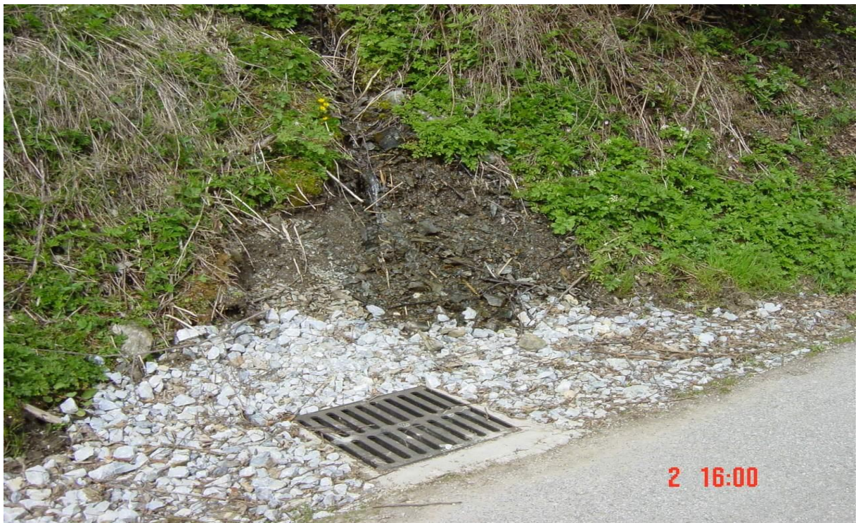
Abbildung 22: Beispiel für die falsche Wahl eines Einlaufbauwerkes
