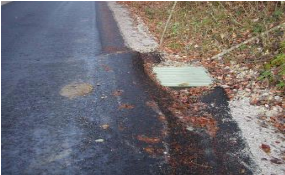
Abbildung 21: Nicht normgerechtes Einlaufbauwerk
