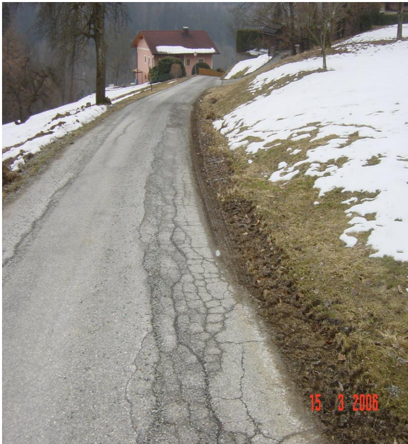
Abbildung 18: Risse am bergseitigen Fahrbahnrand durch das Fehlen einer Entwässerung
